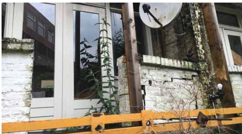
Figuur 1. Instortingsgevaar van één van de huizen in de Margrietstraat door rottende funderingspalen door te lage grondwaterstand (Rijnmond, 2016) 2 .
